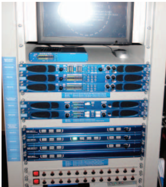
Учет и контроль – основа успеха. Оборудование для мониторинга на стенде Sonifex
