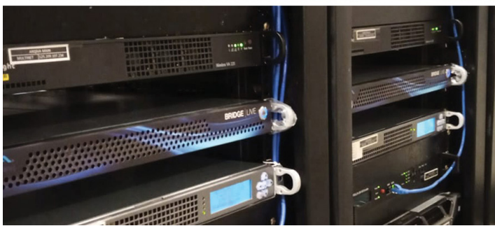
Стойки с оборудованием AJA
