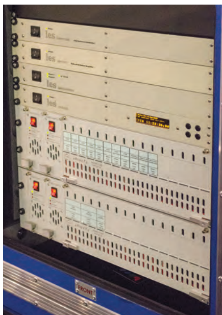
Стойка с оборудованием. Четыре верхних прибора – аппаратура «ЛЭС-ТВ», включая синхрогенераторы серии DG-81 и усилитель-распределитель DS-110V
