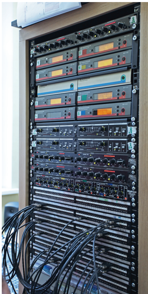
Стойка с оборудованием
