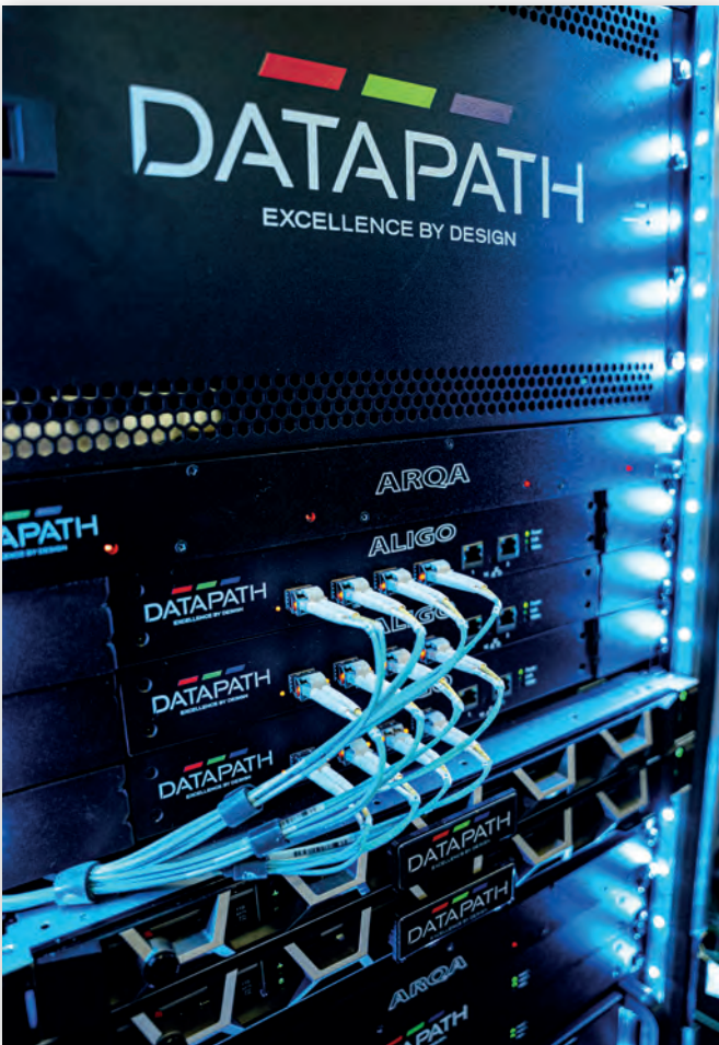
Стелла с сервером и иным оборудованием Aetria
