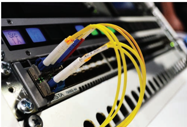
Аппаратная часть системы коммутации Lawo/Arista
