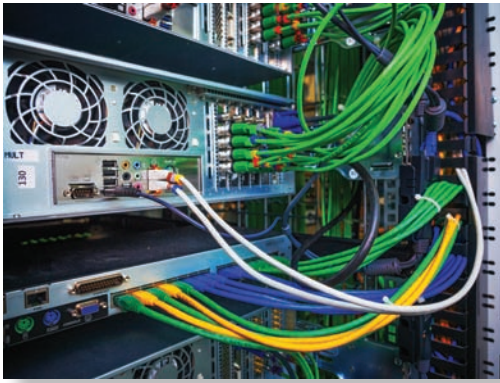
Серверы SL NEO в стойке с оборудованием
