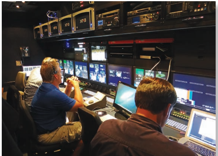
Мониторы Boland, установленные в ПТС компании NESN
