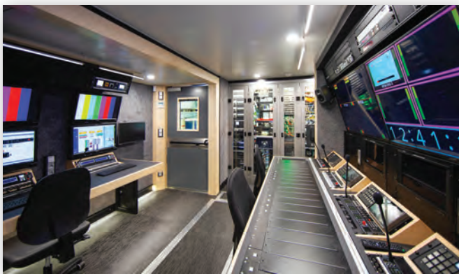
Зона управления трансляцией
