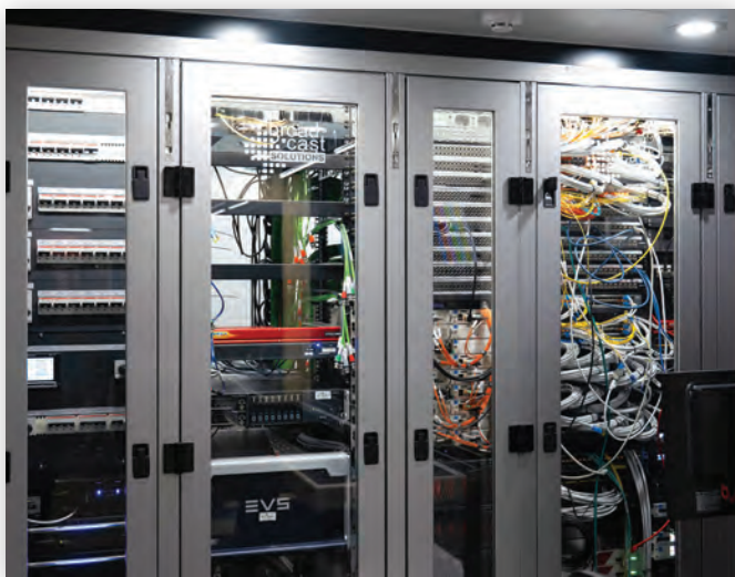
Стойка с системным оборудованием
