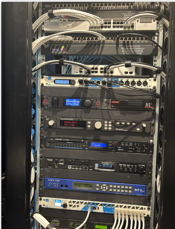
Стойка с оборудованием Lawo
