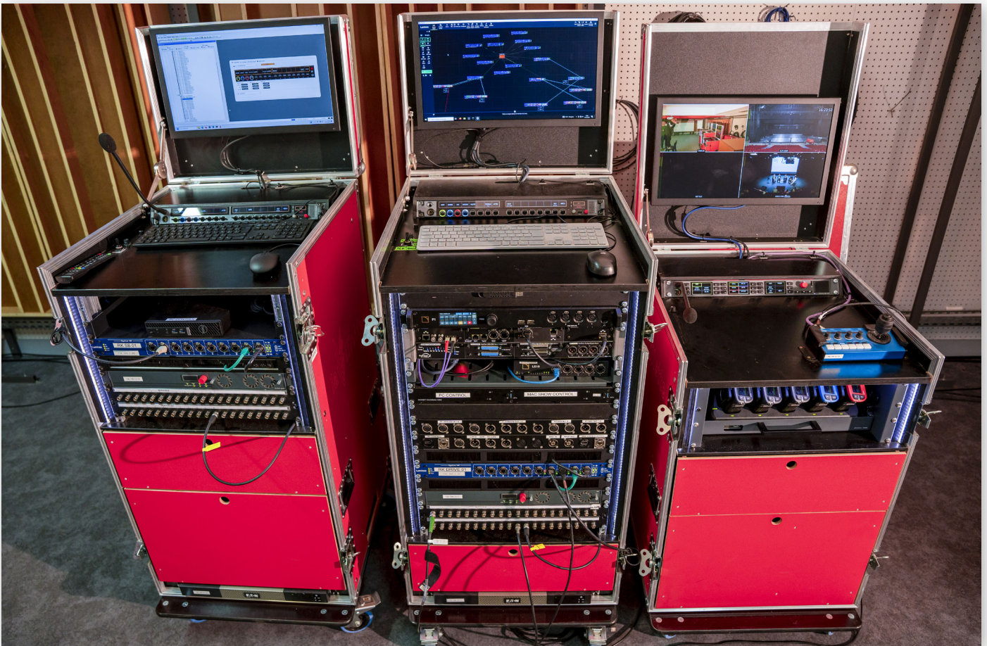
Мобильные кейсы-стойки с оборудованием
