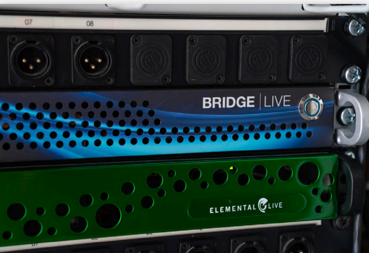
AJA Bridge Live в стойке с оборудованием
