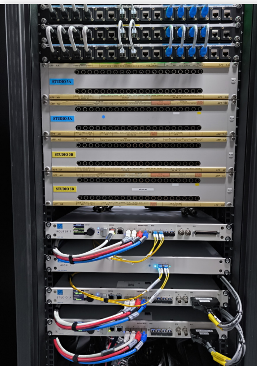
Стойка с оборудованием Lawo
