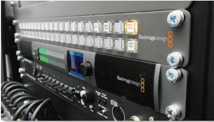
Панель управления матричным коммутатором и станция служебной связи
