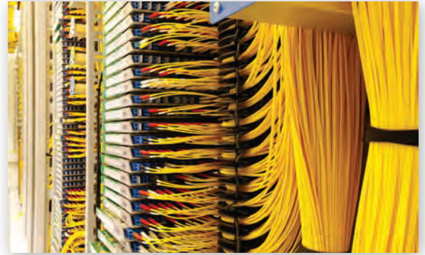
Рис. 11. Кабели и кабельные жгуты, проложенные в помещении
